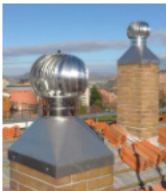
Fig. 06 Extractores eólicos de cuberta
