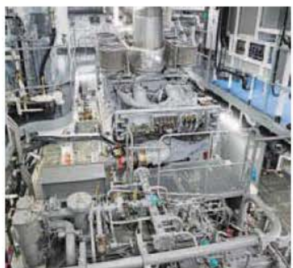
Las tuberías industriales exigen proyectistas especializados. J. PARDO
