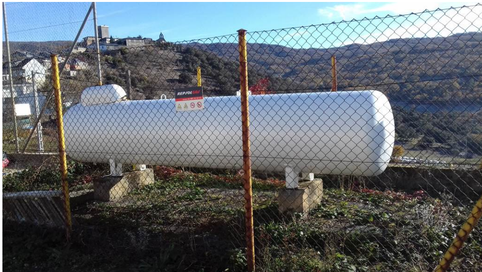
Depósito de gas Propano
