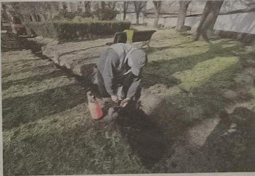
Cerrado desde hace más de un año y alfombrado de hierba, el jardín registró ayer los primeros trabajos para proteger los árboles sanos (al fondo, en la foto) a través de una zanja que partirá el espacio en dos y evitará que la grafiosis se propague por el sistema radicular. En la imagen, un operario corta las raíces que conectan un lado y otro. EDUARDO PÉREZ
