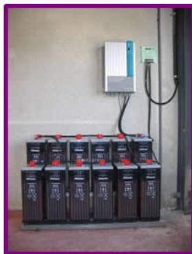
Batería para acumular a electricidade das células fotovoltaicas
