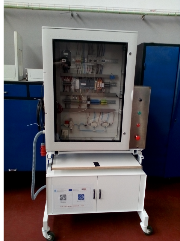
ARMARIO DE CONTROL
