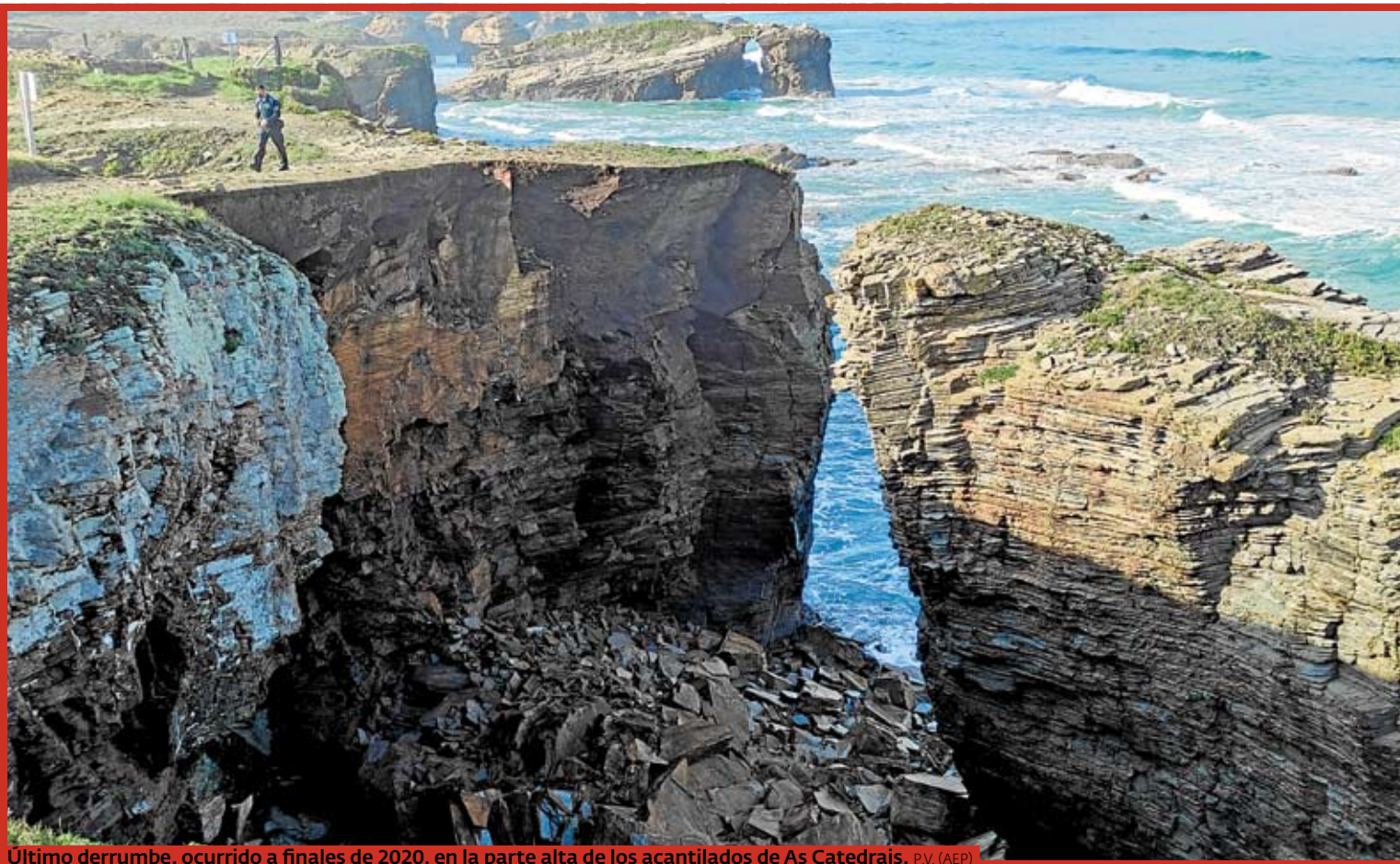
Último derrumbe, ocurrido a finales de 2020, en la parte alta de los acantilados de As Catedrais. P.V. (AEP)
