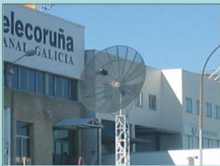
Antena parabólica en TeleCoruña
