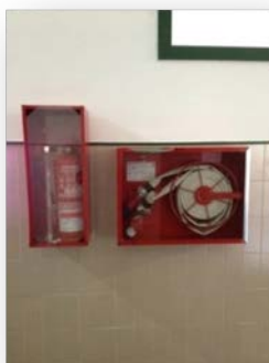
EXTINTOR DE PO E BIE
