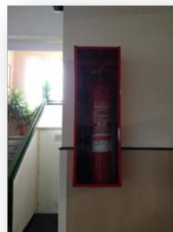
EXTINTOR DE CO2
