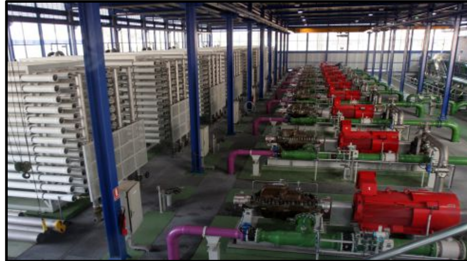
Planta desalgadora de Aguamarga, Alicante
