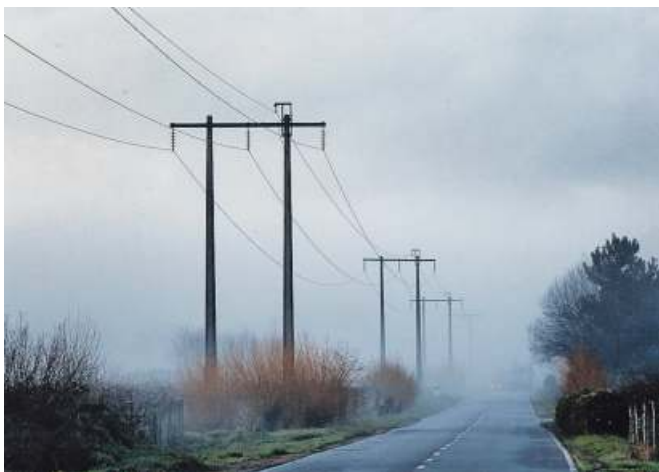
Estos ingenieros son responsables del transporte de electricidad. MÓNICA IRAGO
