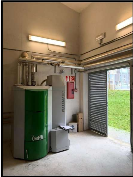
SALA DA CALDEIRA DO EDIFICIO DE INFANTIL
