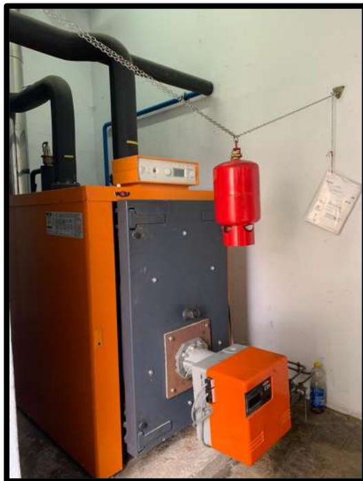
SALA DA CALDEIRA DO EDIFICIO DE PRIMARIA
