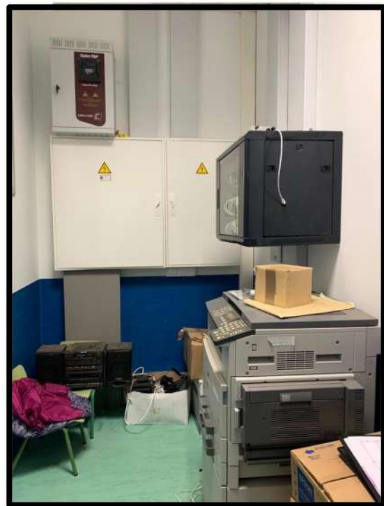
SALA DE CADROS ELÉCTRICOS DO EDIFICIO DE INFANTIL
