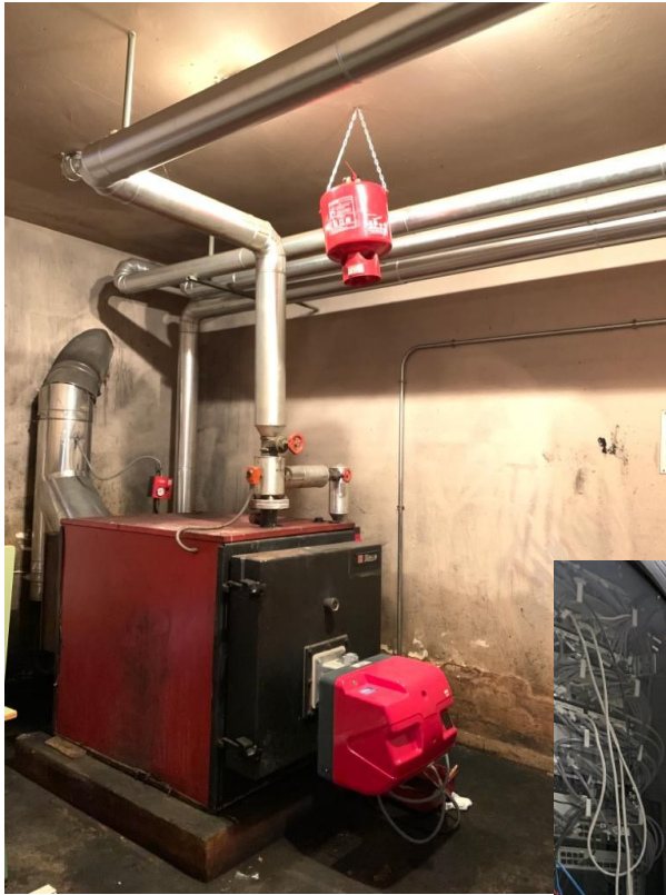
SALA DA CALDEIRA DO EDIFICIO PRINCIPAL
